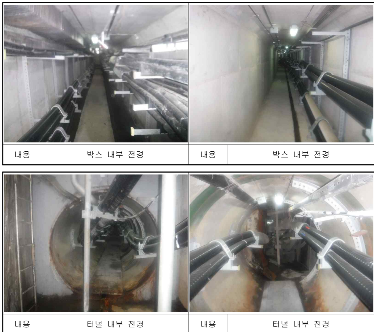
[사진 11.1] 지도SS인출 전력구 현황
